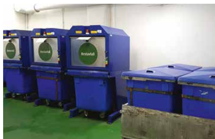
På kjøpesenteret Trondheim Torg benyttes tre rullekomprimatorer til restavfall.
